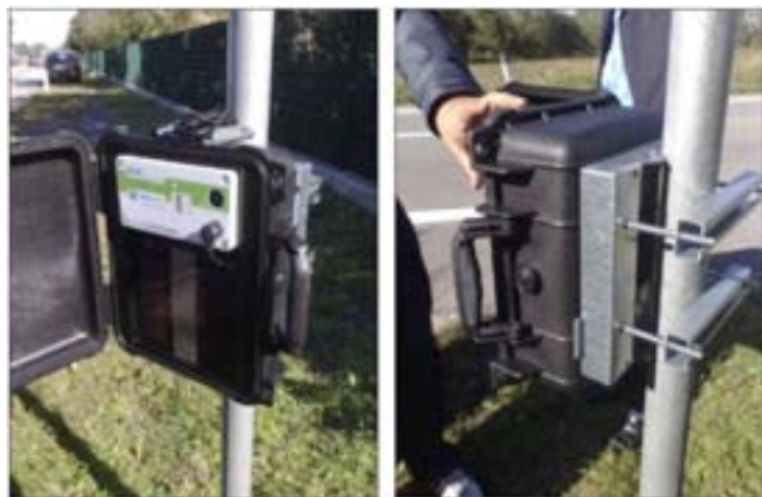
Figura 29 – RADAR SDR-Easydata – Esempio di installazione
