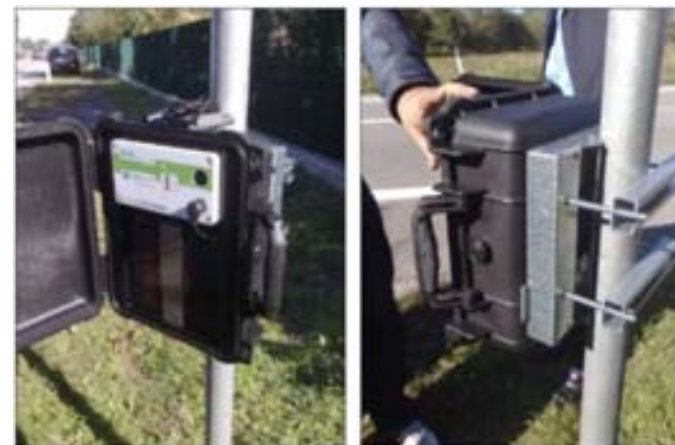
Figura 30 – RADAR SDR-Easydata – Esempio di installazione
